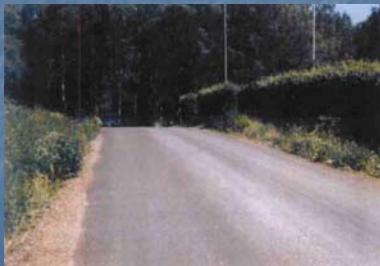
Väg med flygaska ca 7 år efter renovering Askan höll 5 % cement samt även fiberslam
