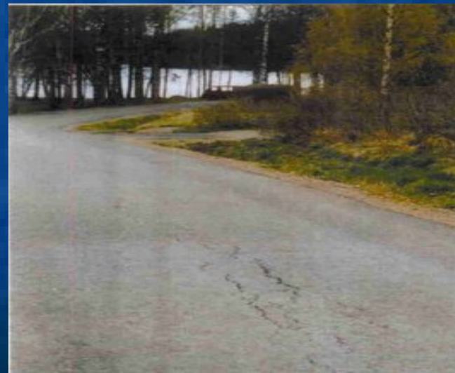
Referensväg renoverad på traditionellet sätt fick sprickor redan efter 1 år
