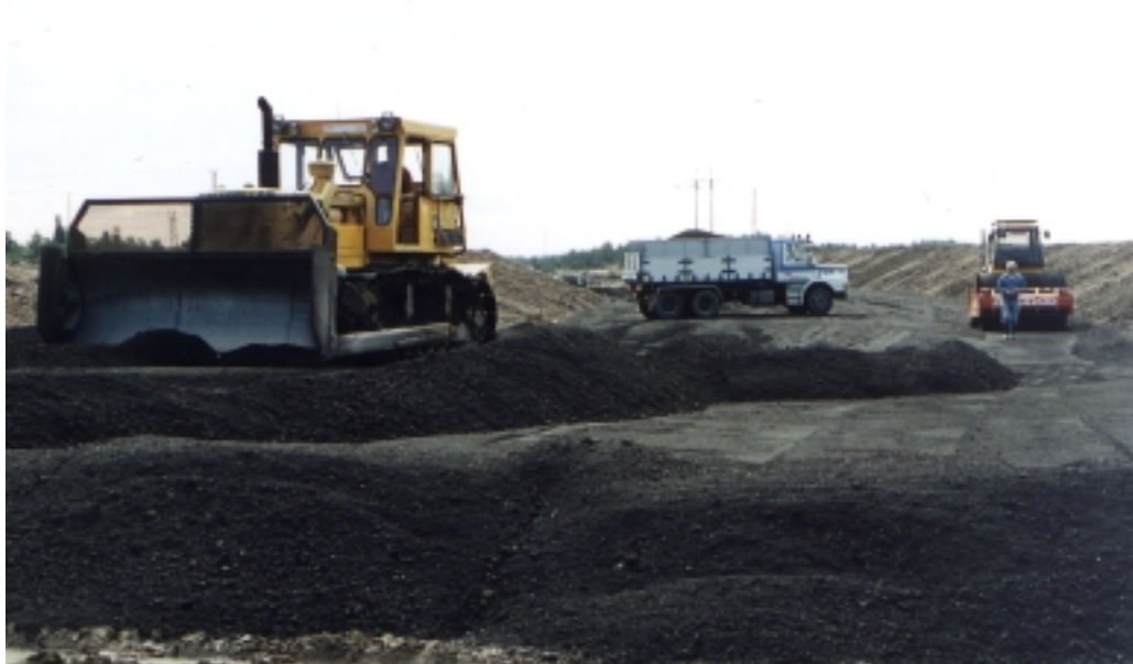
Figur 6.1 Packning av bottenaska från koleldning på roster vid E4:an utanför Norrköping (J. Rogbeck).
