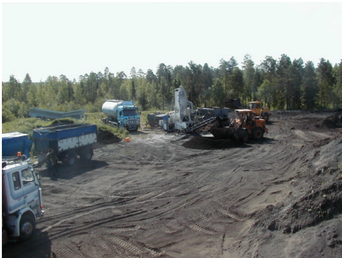
Figur 6-7 Tillverkning av askblandningen med hjälp av blandningsverk och lastning av den färdiga blandningen på lastbilar, Ålandsbrotippen, Härnösand.
